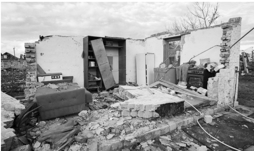
Рис. 4. Повністю зруйнований цегляний будинок (капітальна споруда) у місті Буринь внаслідок проходження смерчу. Характер пошкоджень відповідає категорії F3. Матеріали ДСНС
